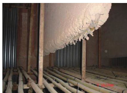
图 9 屏浇注料脱落引起的磨损
