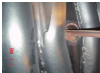
(a) 热电偶开孔部位磨损
