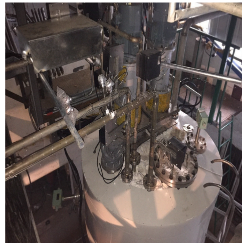
(d) The top of hot salt tank
